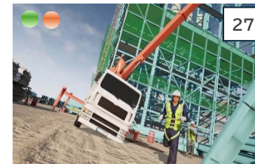
安全確認不足によるクレーン事故
