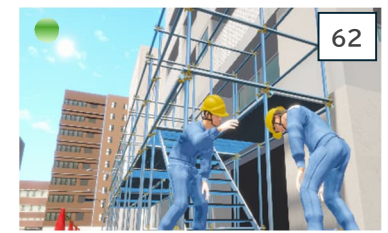
足場撤去現場での熱中症
