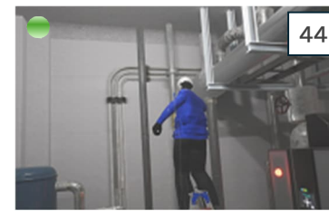
脚立からの墜落(配管レバー締め)
