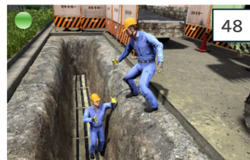
埋設配管作業中の法肩滑落
