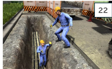
埋設配管作業中の法肩滑落
