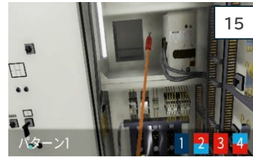
キュービクル点検作業
